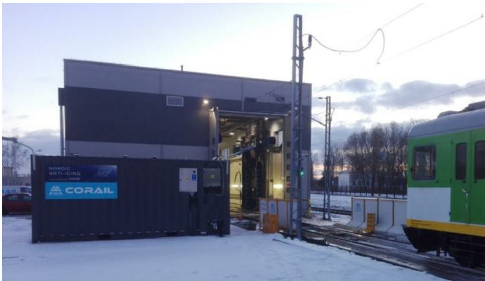
Instalacja anty-oblodzeniowa w Tuszczu
